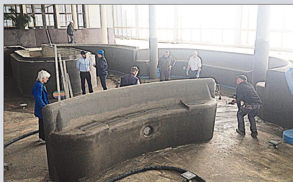
Eine der bekannten Baustellen der letzten Zeit war die Kocheler Kristalltherme im ‚Trimini‘. Hier stellten die Aufteilung der Becken sowie die erforderlichen Gefälle für dutzende Ablaufgullys eine besondere Herausforderung dar.
